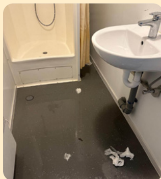
Figuur 18: Onhygiënische gedeelde sanitaire voorzieningen, geplaatst in een evenementenhal (bron: foto genomen door een kind in het photovoice-project van de Onderzoeksraad voor Veiligheid).
