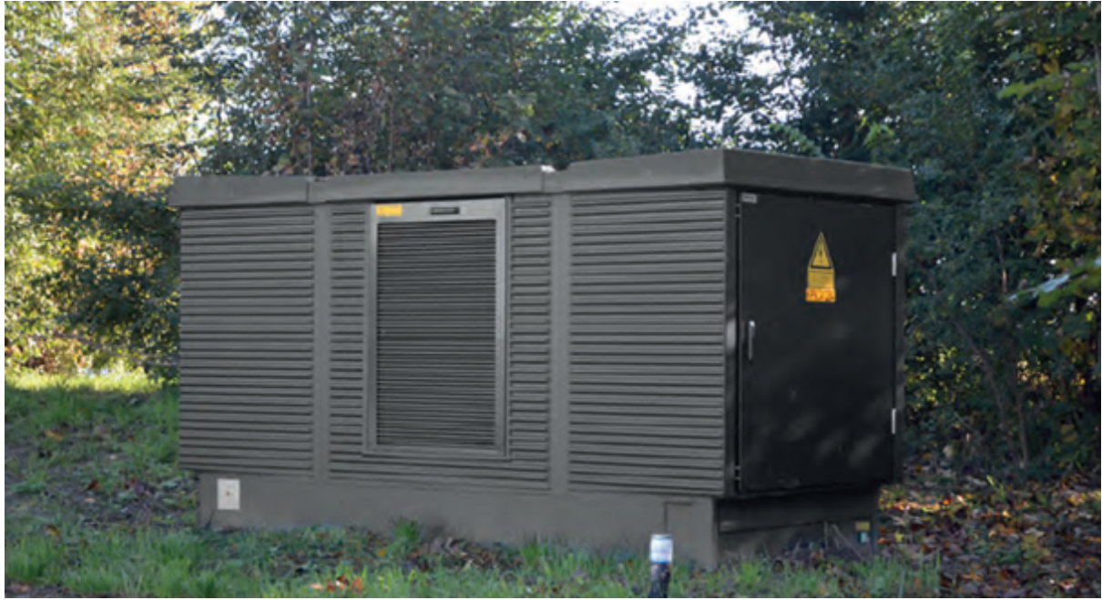
Referentiebeeld transformator, Diabolo 5HL bron: alfen.com
