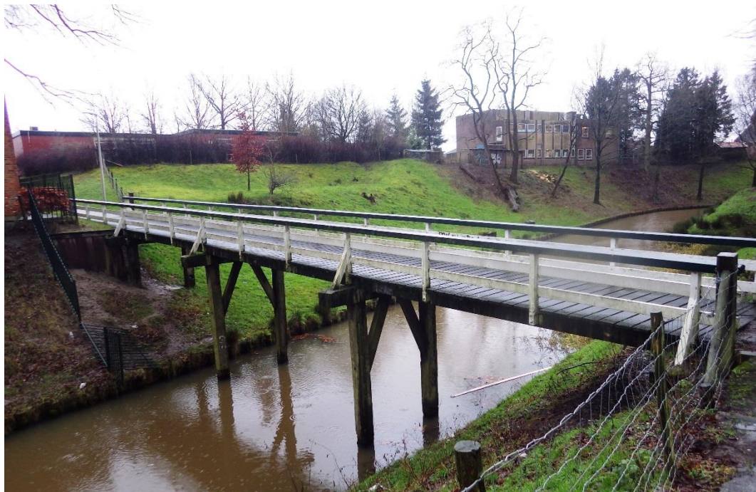
Figuur 9 Brug in Steenwijk in matige staat.
