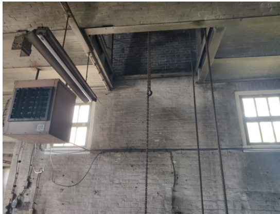
Gasgestookte luchtverhitter naast het luik voor de kraan
