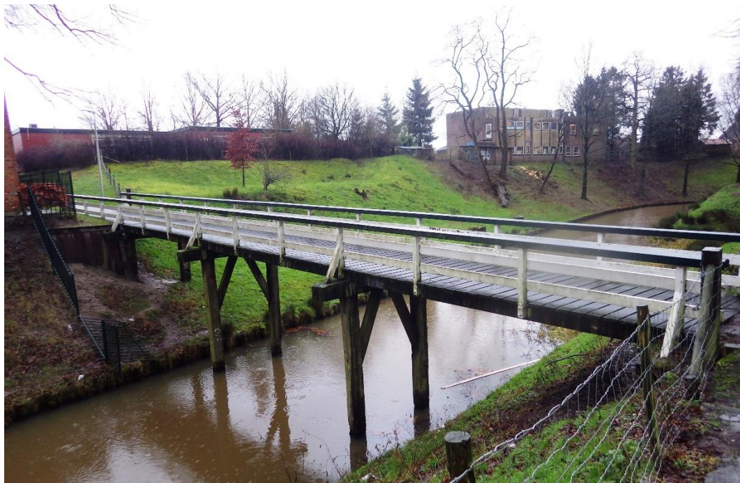
Figuur 9 Brug in Steenwijk in matige staat.
