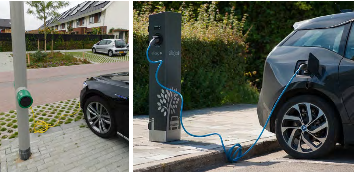
laadpunt gecombineer met lichtmast
