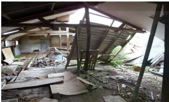
Ingestort gedeelte schuur 1
