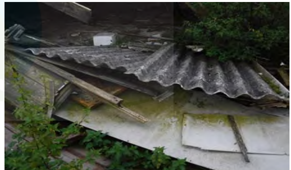
Ingestort afdak bij schuur 3
