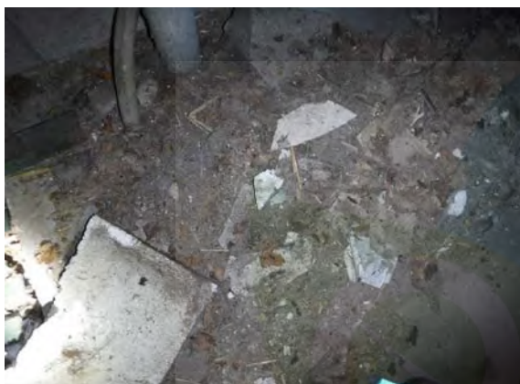
Restanten asbesthoudende plaat op de vloer
