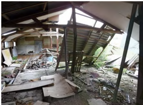
Ingestort gedeelte schuur 1
